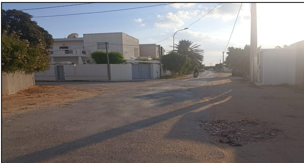
Chaussée totalement dégradée
