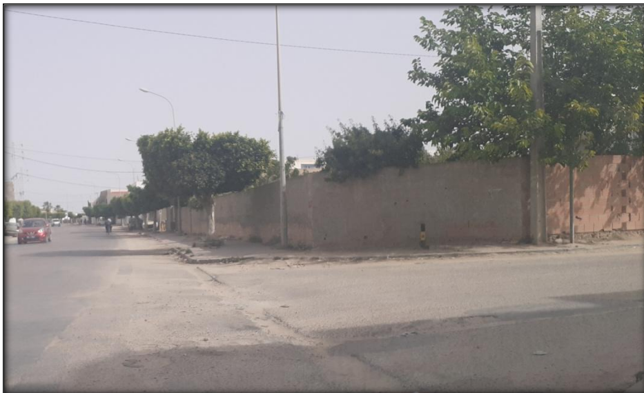
Figure 11: Chaussée dégradée au niveau des raccordements
