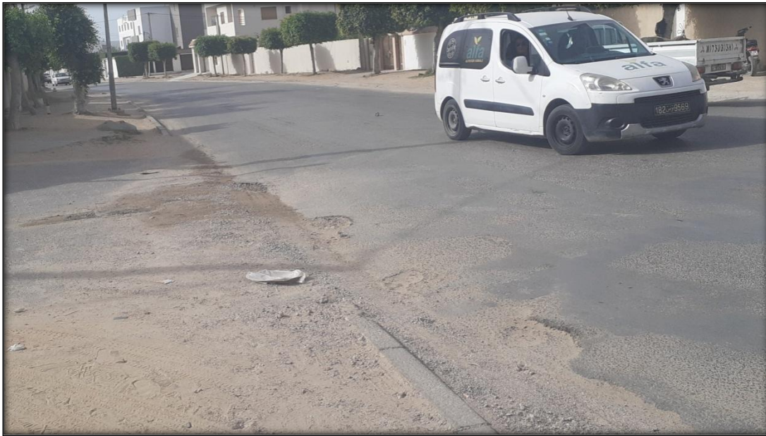
Figure 12: Dégradation des bords de la chaussée
