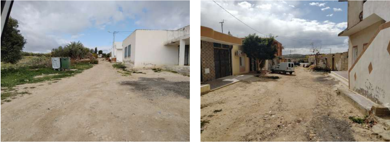
Figure 2: Etat actuel de la voirie dans les zone d'intervention
