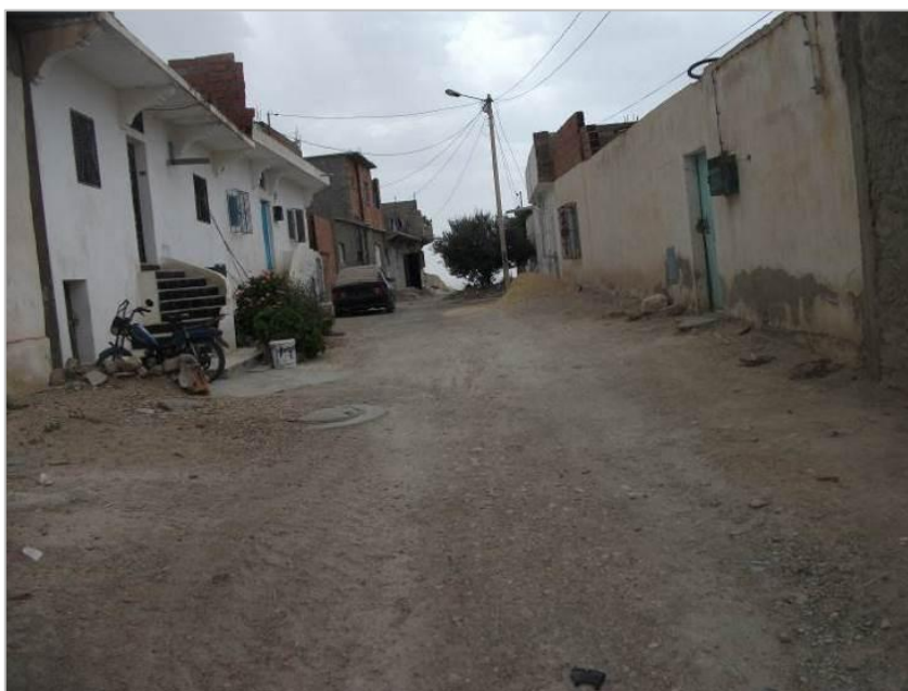
Figure 8: Voirie éclairé par la pose des foyers sur les poteaux de la STEG
