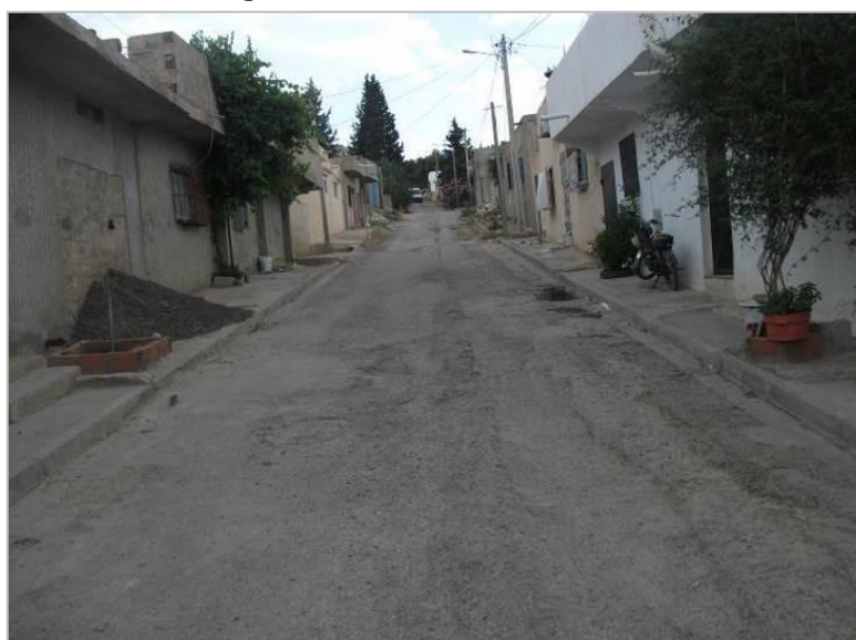
Figure 6: voie en bicouche complètement dégradé
