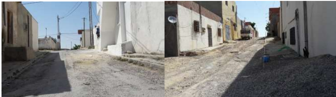
Figure 4: Exemple des voies dégradées au quartier Monji Slim
