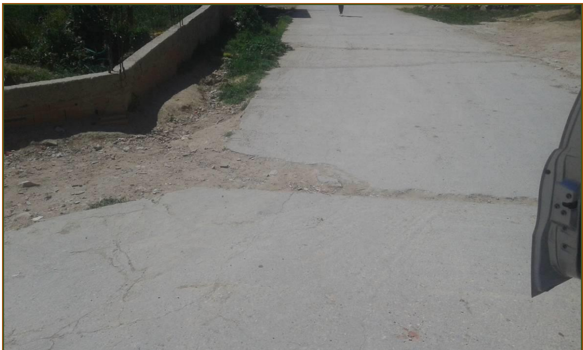
Photo 3 : Voie en BC dégradée au quartier Ras Ain.
